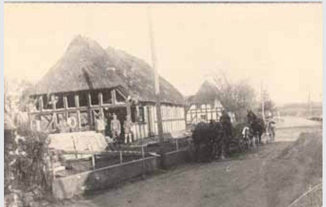
B 906 - Foto fra 1928 - Svendborgvej 429 Malermester Harald Madsens gamle hus rives ned, for at kunne bygge et nyt på grunden.
